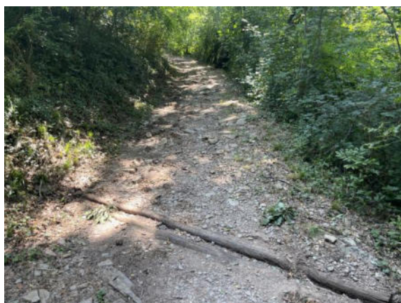
FOTO 3: TRATTO 2 EROSIONE FONDO E CANALETTA DANNEGGIATA
